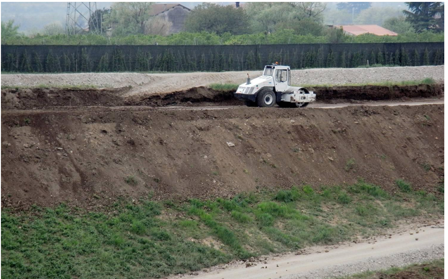
DETTAGLIO LATO OVEST - stesura di: Terreno vegetale limoso-sabbioso color marrone con ghiaia e rari ciotoli? Per la strada perimetrale e per la sagomatura della parete dell'ex cava trattasi sempre di MATERIALE DI RIPORTO
