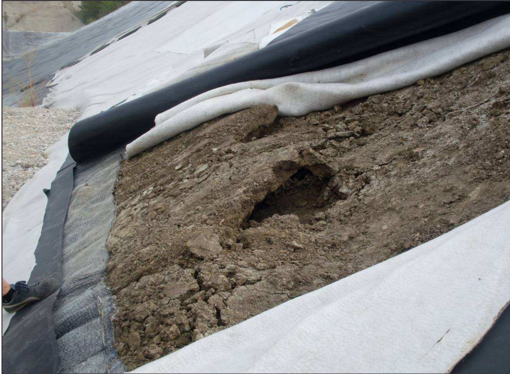
Figura 3 – Particolare del rigonfiamento dell'argilla alla base della sponda est del Lotto n. 2.
