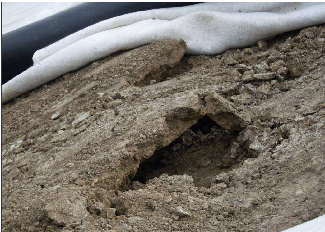
Figura 4 – Particolare del rigonfiamento dell'argilla alla base della sponda est del Lotto n. 2.
