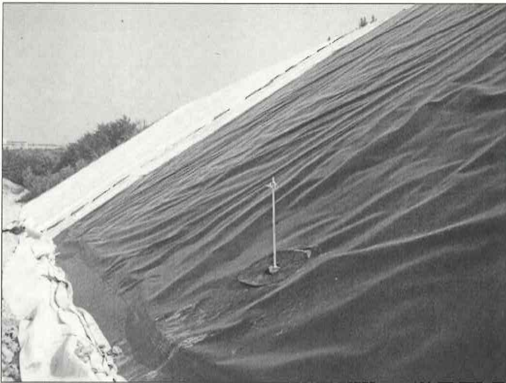
Figura 7 – Particolare della base della sponda est del Lotto n. 2 al di sopra del terrapieno di sostegno.
