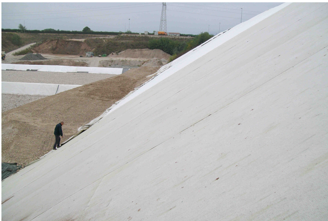
Foto 3: Sponda est lotto 1 – fasi di verifica della scarpata libera
